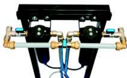
Detail obchozího potrubí
